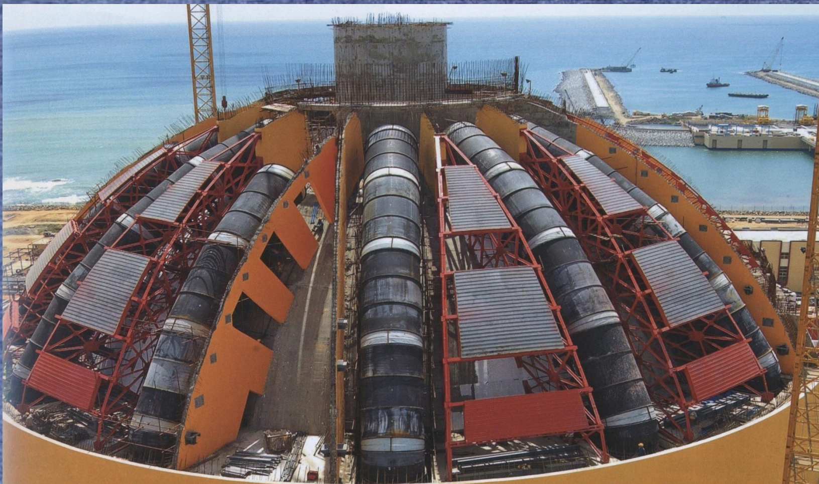
Воздуховоды системы пассивного отвода тепла АЭС «Куданкулам»
